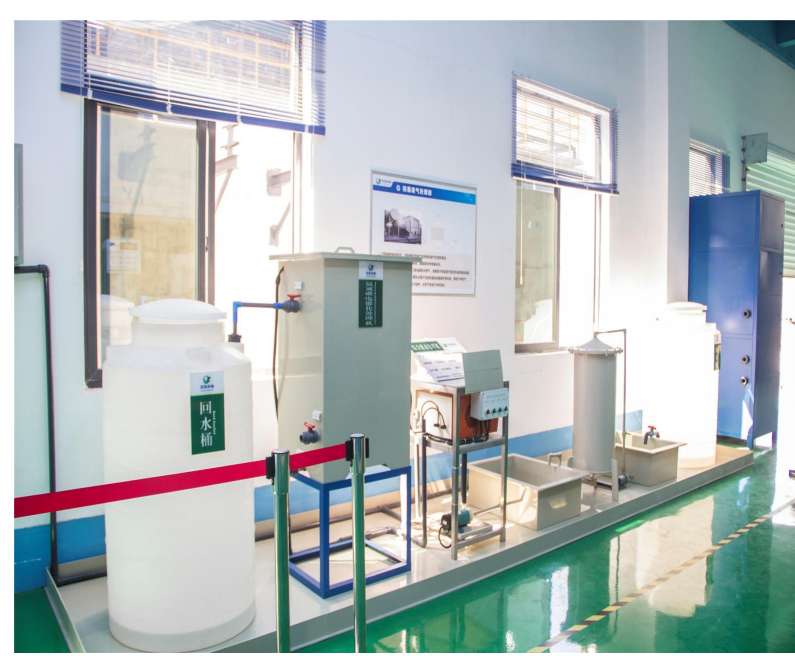
巨科环保电镀废水闭环循环装置。
