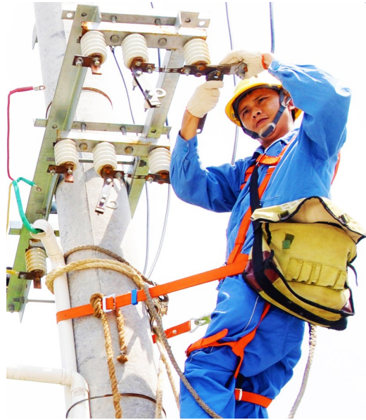
⑨改造农网设备
